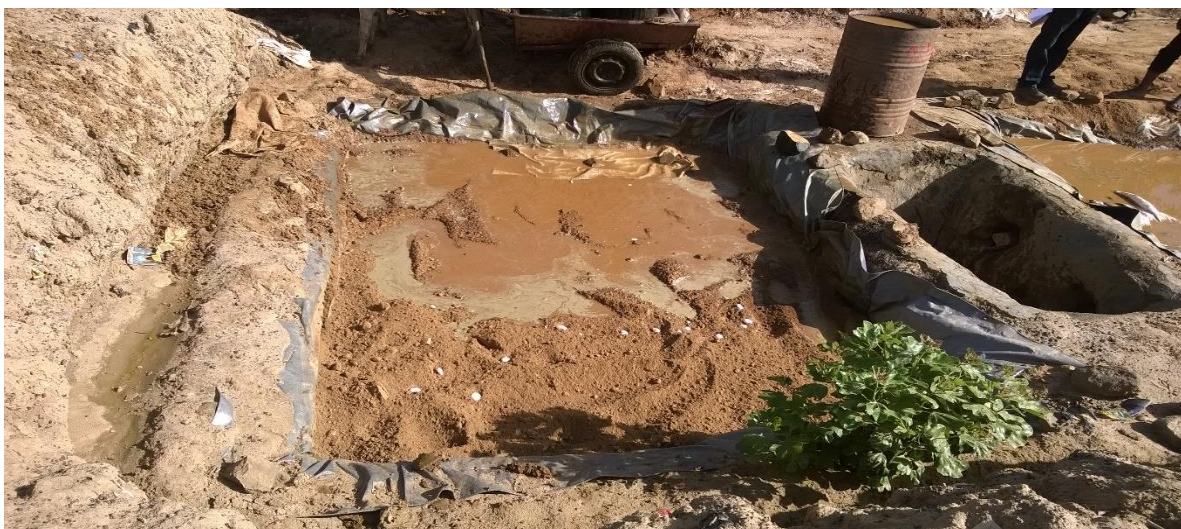
Figure 17: Bassin de cyanuration en préparation
