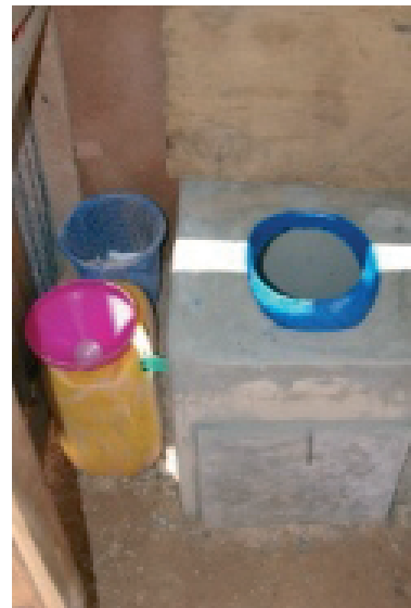
“Bidur” installé à côté de la toilette ECOSAN d’un agent du CREPA
