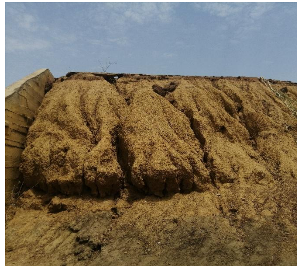
Photo 4 : Erosion marquée du talus aval au droit du déversoir
