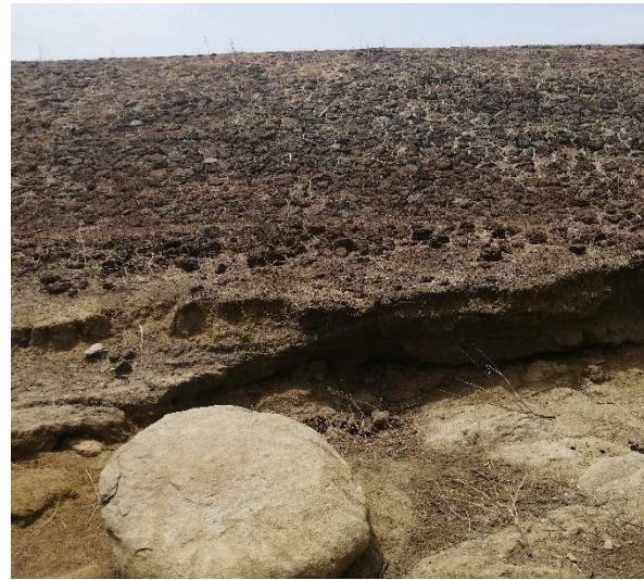
Photo 2 : Absence de fossé de pied amont et érosion à la base de la digue
