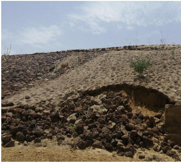
Photo 1 : Désorganisation des moellons du talus amont au droit du déversoir
