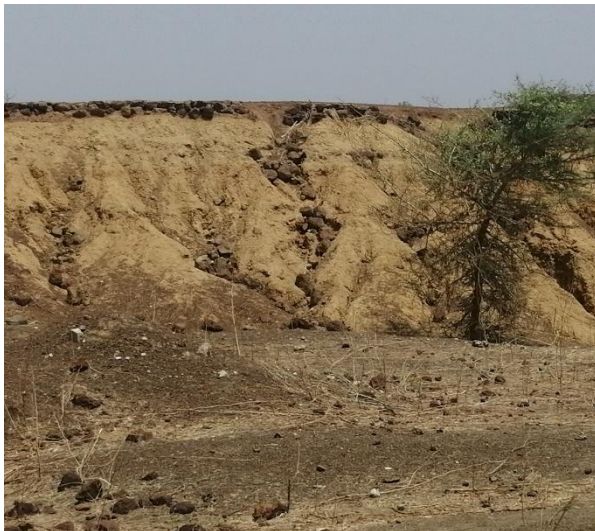
Photo 3 : Erosion marquée du talus aval et présence d'arbustes
