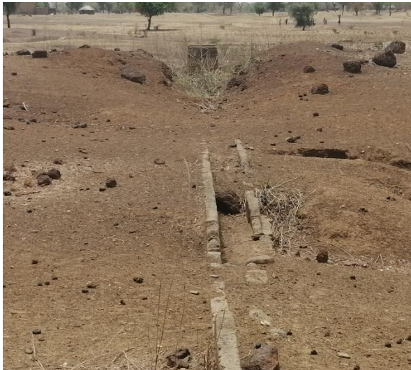
Photo 8 : Canal primaire comblé
