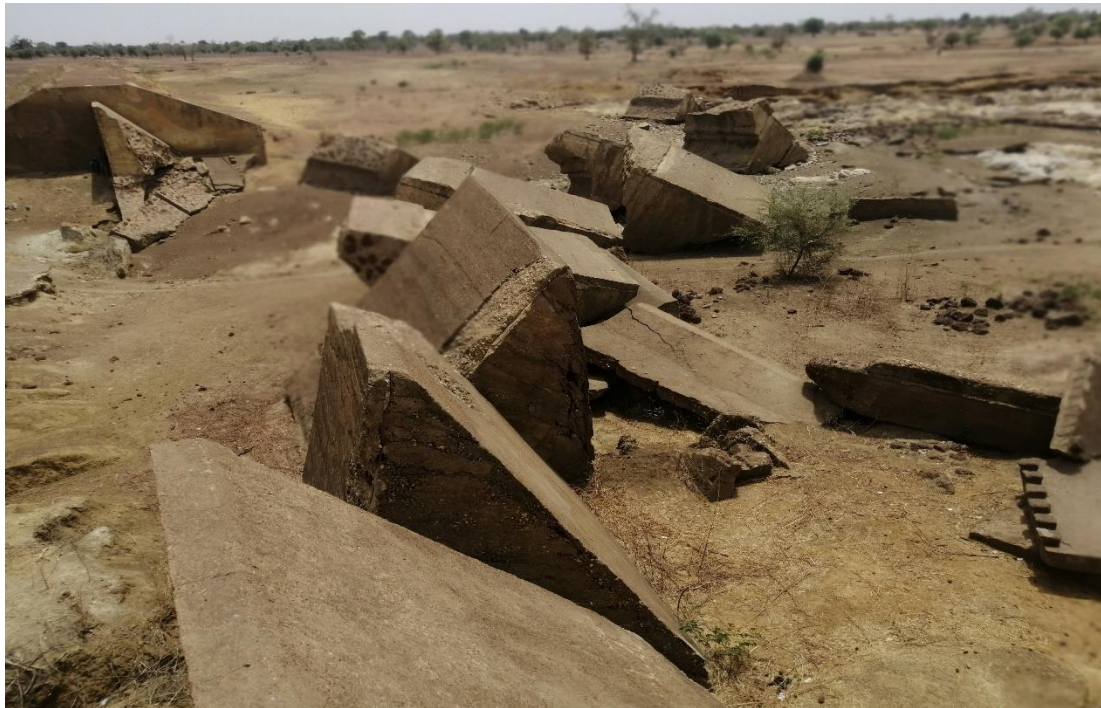
Photo 5 : Déversoir en ruine
