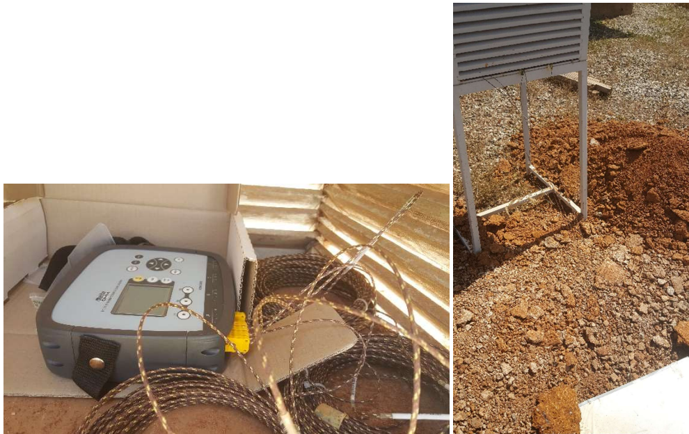
Figure 23 : Mise en place du Datalogger HD32.8.16
