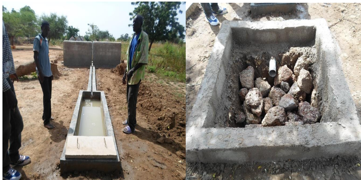
Figure 7 : Puits perdu, décanteur, abreuvoir, canal et muret de protection dans le village de Bounou Natimsa
