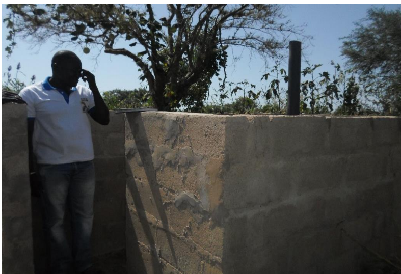
Figure 9: Latrine subventionnée par REGIS-ER dans le village de Maldyanga
