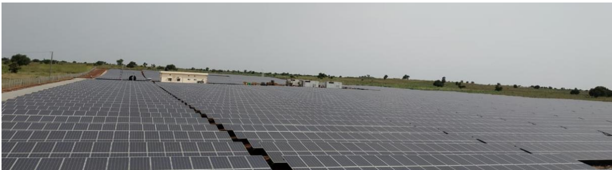
Figure 3-1 : Image prise à la centrale solaire PV de Malbaza
