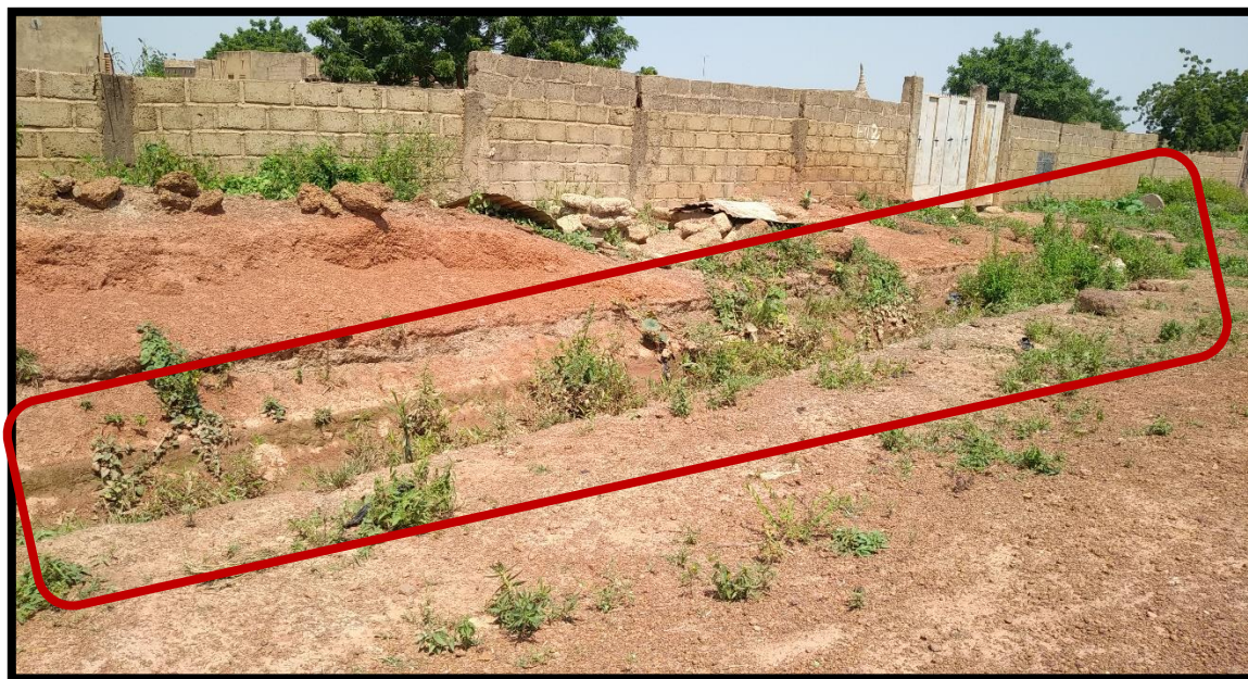
Figure 6: Obstruction et dégradation des caniveaux existants sur le site de Taonsgo
