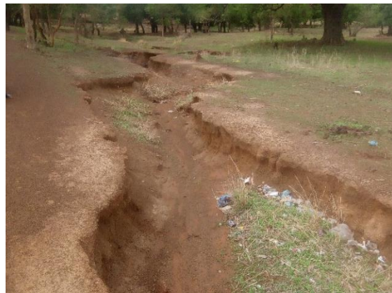
Photo 2 : Dégradation du pied de la digue
