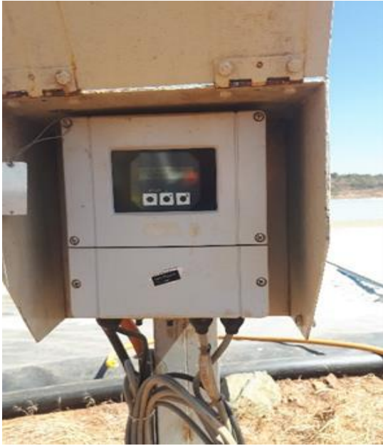
Image 2 : Compteur d'eau du barrage de retenue d'eau (WSD)
