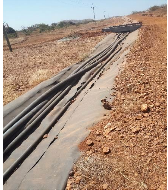
Image 3 : Conduites d'adduction et de refoulement des eaux brutes du WSD et TSF
