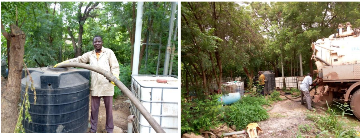
Figure 3 Remplissage des réservoirs de stockage
