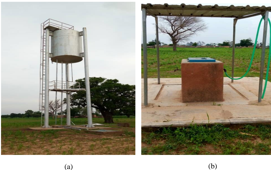
Figure 5 : Réservoir (a) et borne fontaine (b) de l'AEPS de Garpéné
