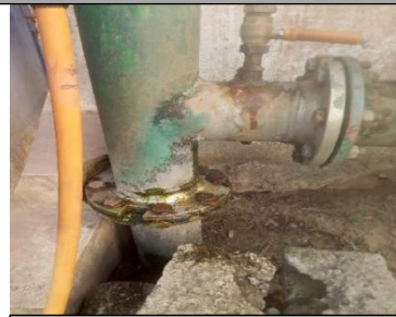
Fuite sur le réseau
