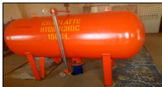
Anti béliet installé depuis 1978, risque d'accident
