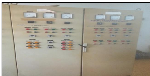
Armoire de commande des forages défectueuse
