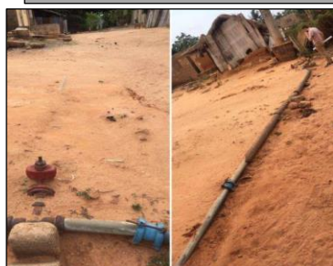
Canalisation mis à nue
