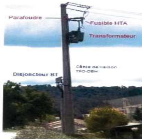
Figure 5: Poste Haut de Poteaux (H61) [1]
