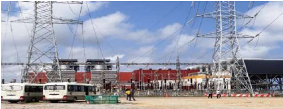
Figure 4: Poste source d'AZITO
