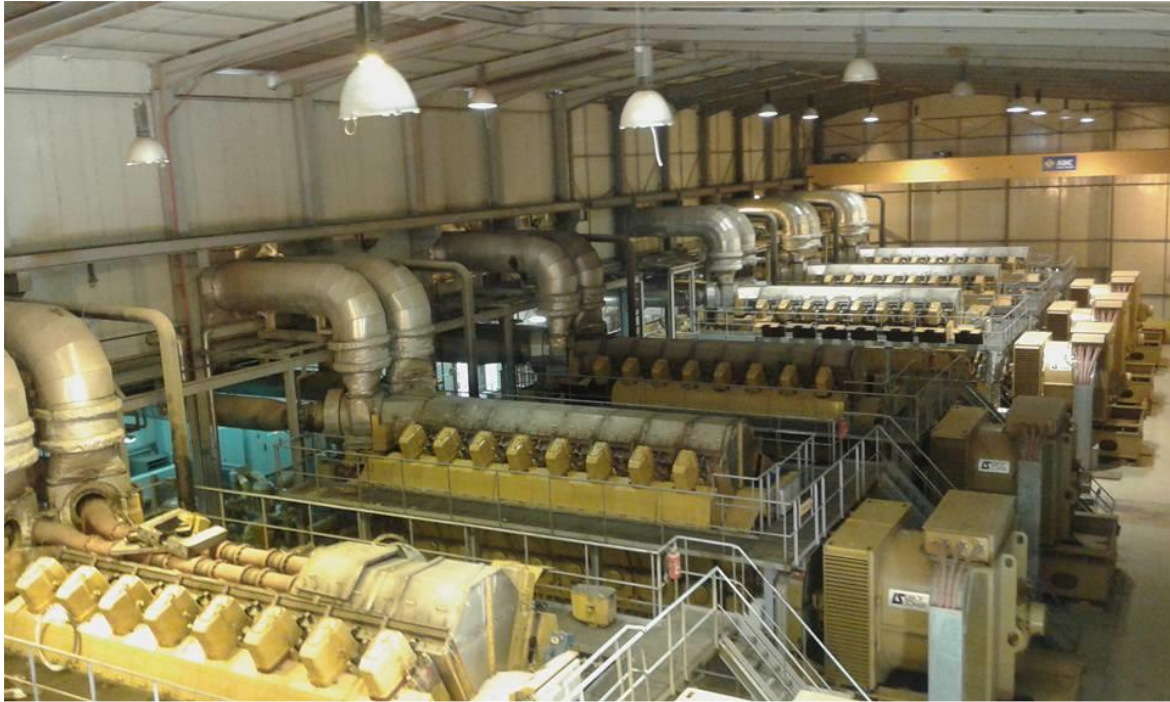
Figure 4 : vue des groupes CATERPILLAR
