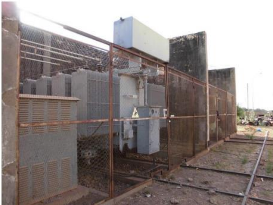
Figure 2 : Vue dun transformateur 33/15 kV du poste OUAGA 2
