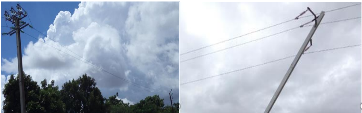
FIGURE 15 : Quelques incidents rencontrés sur les départs 15 kV de Ouagadougou
