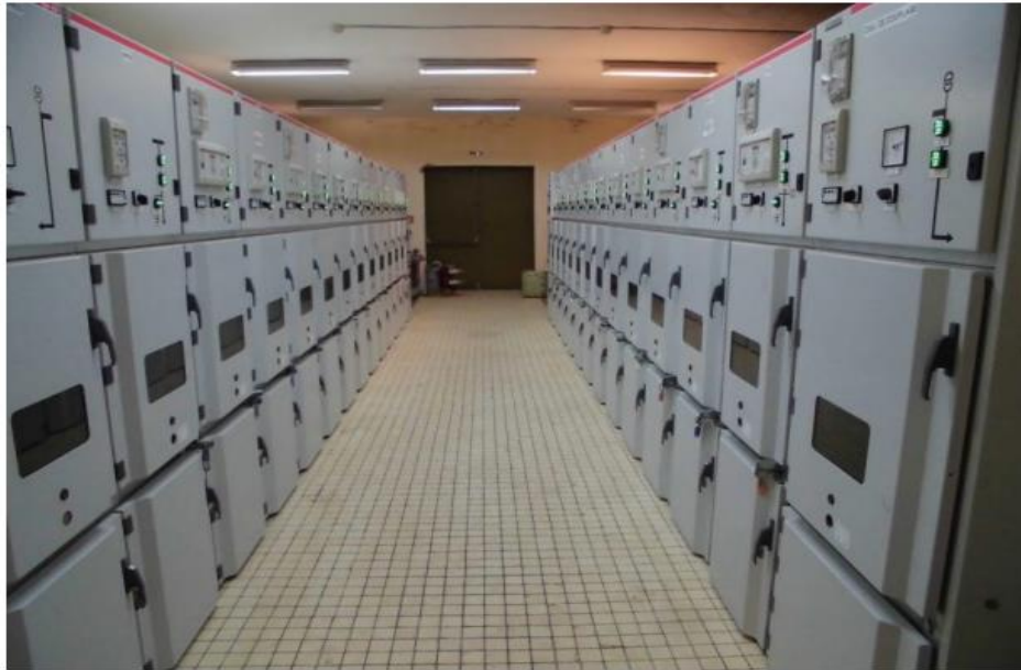
Figure 1 : Vue d'intérieur du poste OUAGA 2
