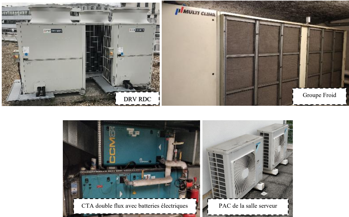
Figure 8: Vues des générateurs de chauffage/refroidissement
