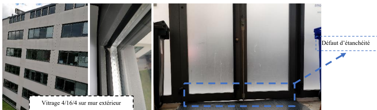
Figure 6: Vues des ouvrants et des éventuels défauts d'étanchéités
