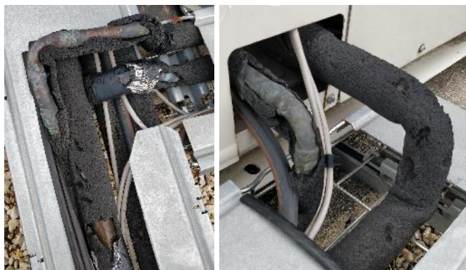
Figure 10 : Dégradation du calorifugeage sur le circuit de distribution du site EPSON CLICHY
