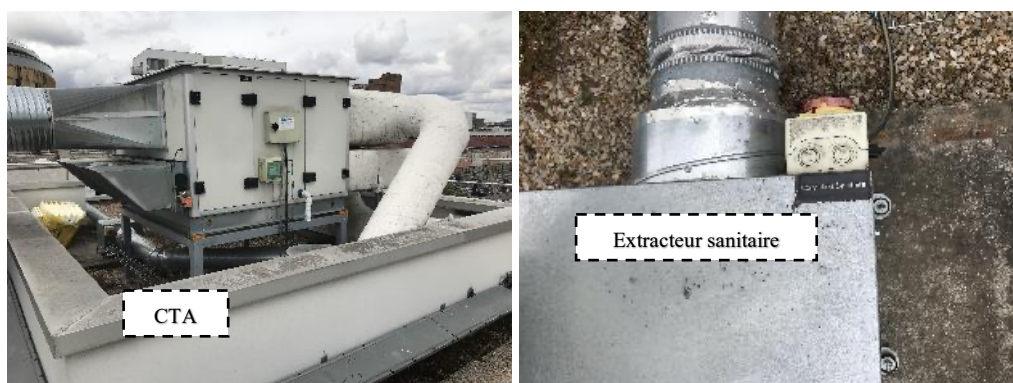
Figure 14: Équipements de renouvellement d'air
