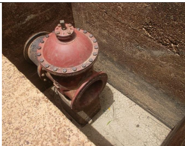
Photo 7 : Aperçu de l'état de la vanne (vétuste) (Source : AGETEER, 2017)
