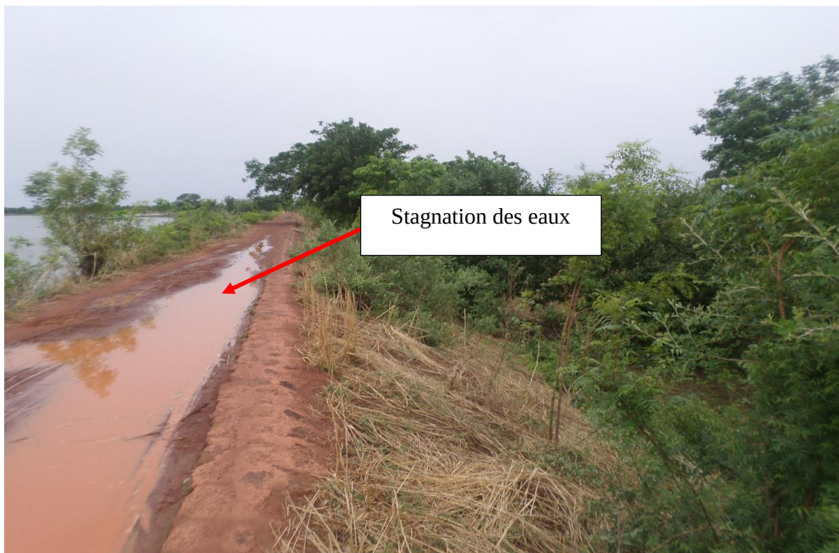
Photo 1 : Des affaissements sur la crête de la digue entraînant une stagnation des eaux (Source : AGETEER, 2017)
