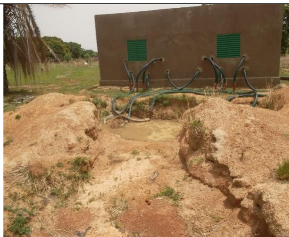
Photo 8 : Aperçu de la station de pompage du PAFASP (Source : AGETEER, 2017)
