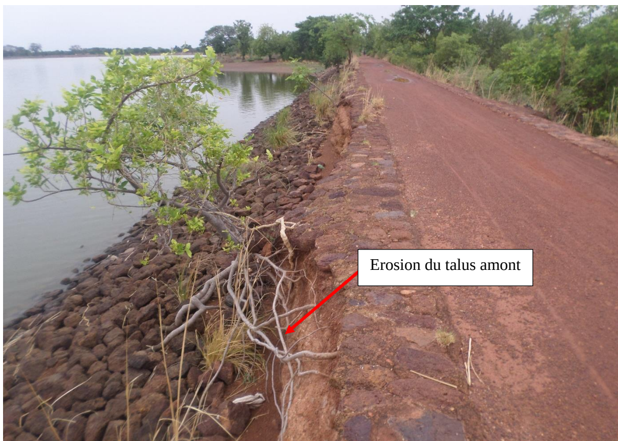
Photo 2 : Erosion du talus amont (Source : AGETEER, 2017)
