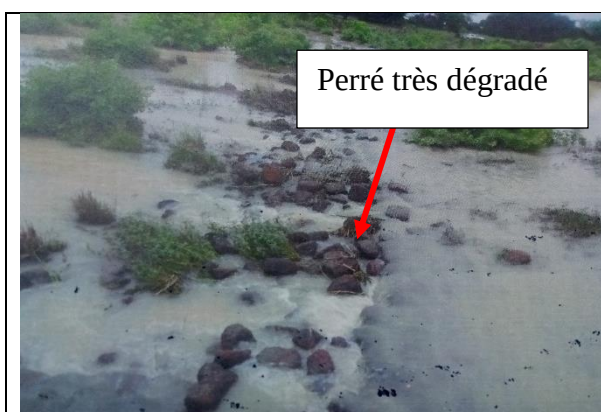
Photo 4 : Protection aval du seuil dégradé en rive gauche (Source : AGETEER, 2017)
