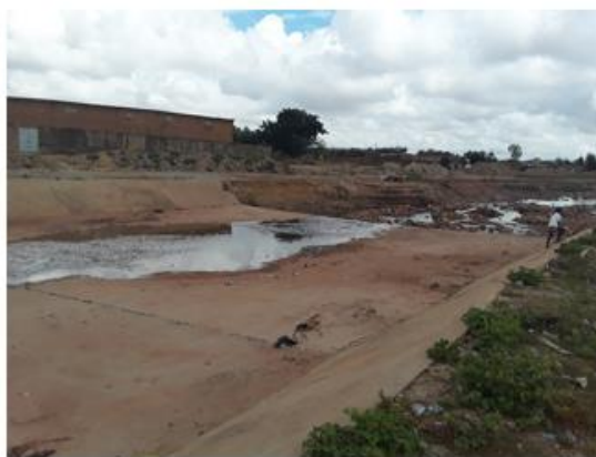
Photo 25 : Quelques travaux d'assainissement pluvial inachevés dans la cadre du SPAQPO
