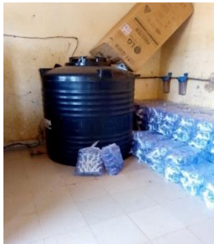
Figure 5 : le réservoir de stockage d'eau
