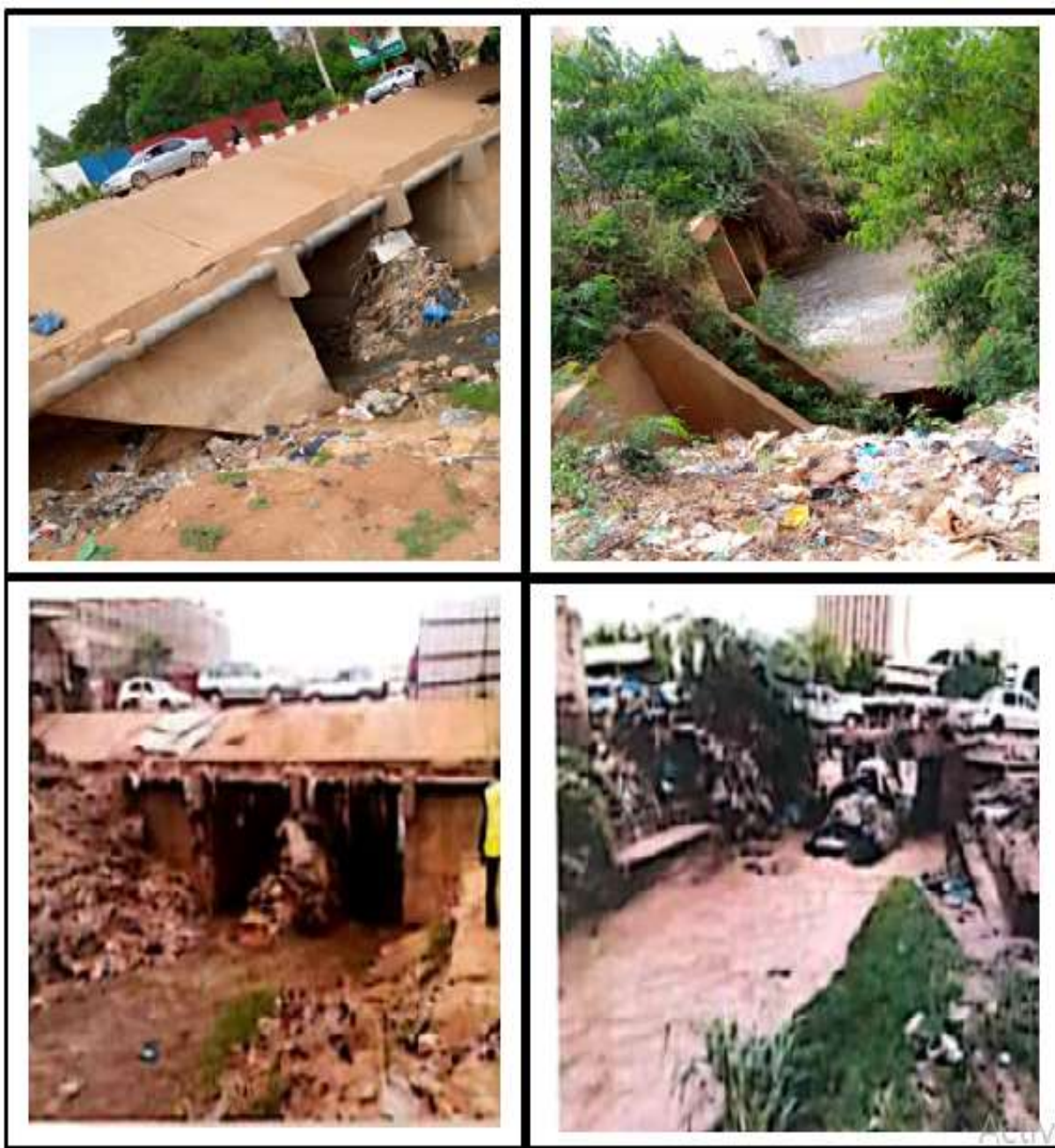
Figure 2 : les images de l'ouvrage existant en mauvais état
