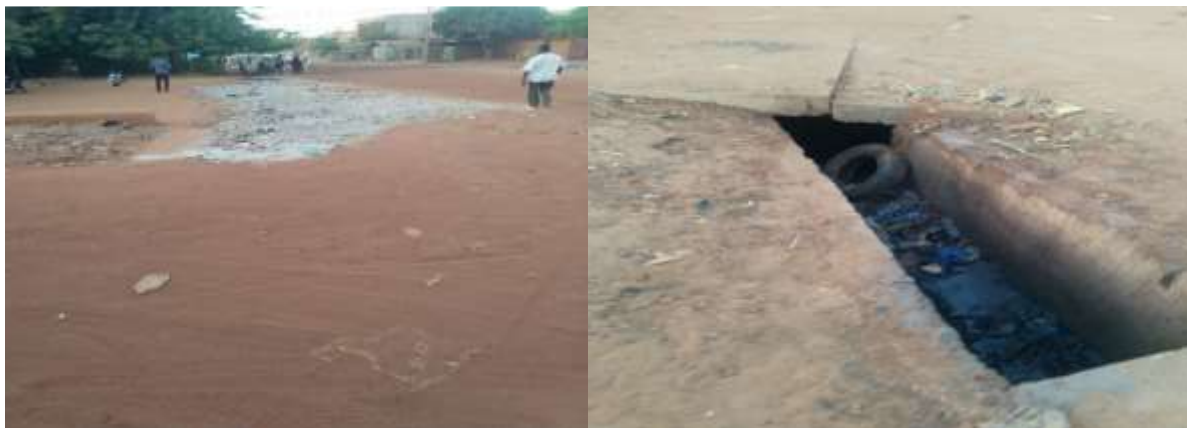
Figure 3 : Etat de la voie existante
