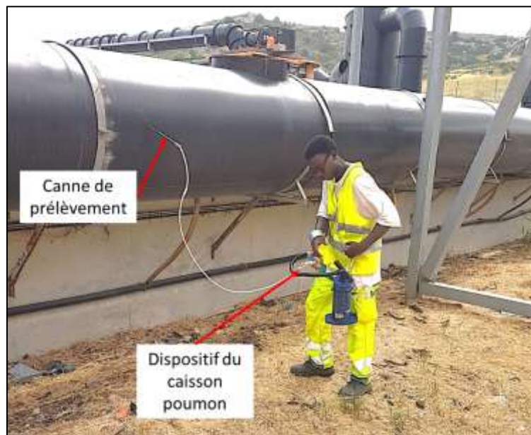
Figure 10 : Prélèvement d'air dans une canalisation
