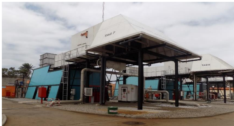
Figure 4: Les turbines à Gaz 4-5-6
