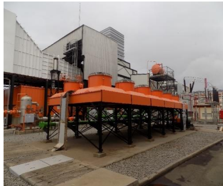
Figure 10: Moteurs aéroréfrigérant 400V
