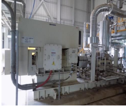
Figure 11: Moteur pompe alimentaire 6.6kV
