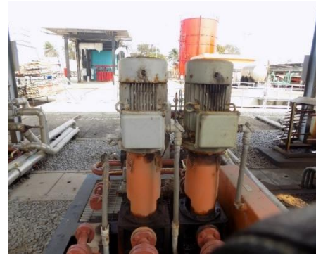
Figure 9: Moteurs pompes de combustible
