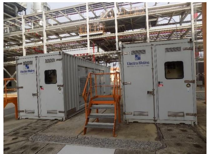
Figure 7: Les groupes électrogènes Diesel 1500kVA
