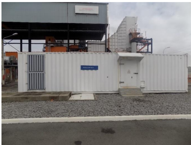
Figure 6: Le groupe électrogène Diesel 1000 kVA
