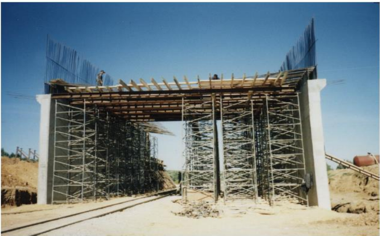
Figure 13 : Etaieiment vertical et horizontal pour le passage du train lors de l'exécution du portique de la déviation nord de Hammamet (travaux par l'entreprise Châabane) [1]
