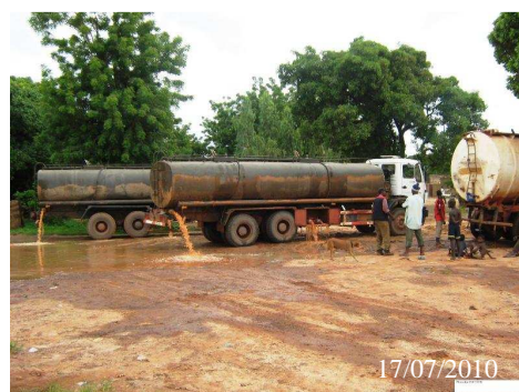
Photo IV 2: Déversement des eaux usées de chantier dans le barrage
