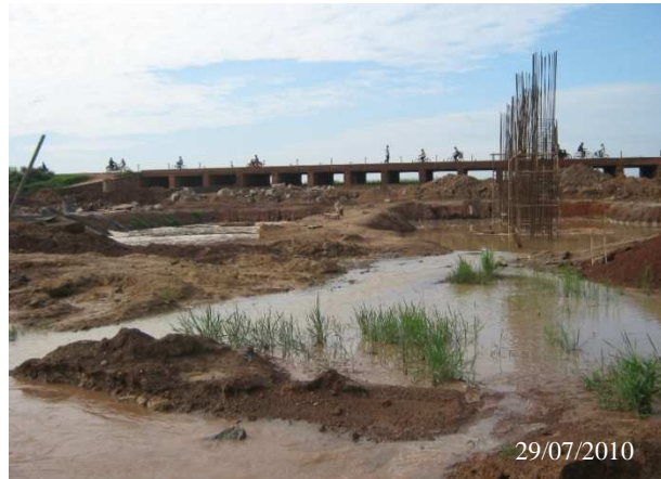
Photo IV 6: Inondation du chantier de construction du pont de Boulmiougou
