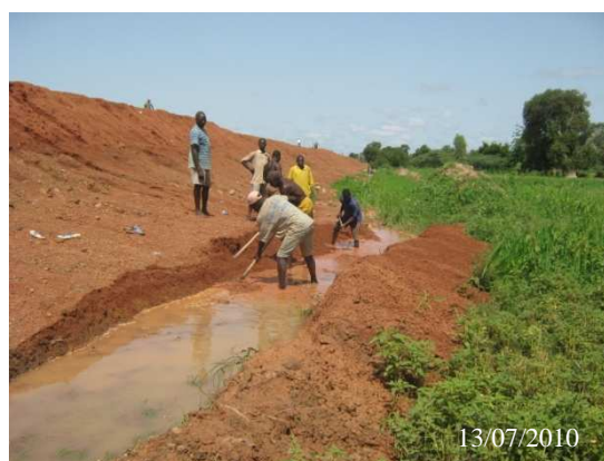
Photo IV 5: Canalisation des eaux du chantier et destruction de la semelle de la RN1
