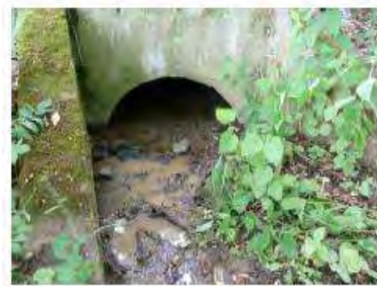
Photo 2 : Buse envasée (source diagnostic de l'ERA)
