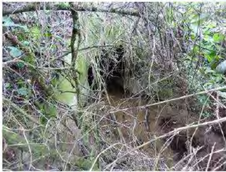
Photo 1 : OHT encombré dans les végétaux (source diagnostic de l'ERA)
