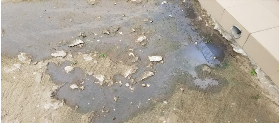
Evacuation des eaux usées domestiques (eaux de lessive) sur la voie publique à Cocotomey, Novembre 2020
