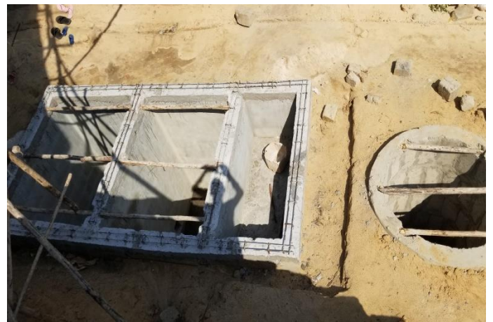
Fosse septique en construction avec deux compartiments de volume égal à Godomey, Octobre 2020
