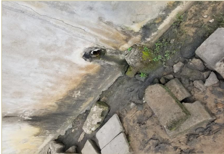
Figure 6: Evacuation des eaux de douches sur la voie publique à Godomey
