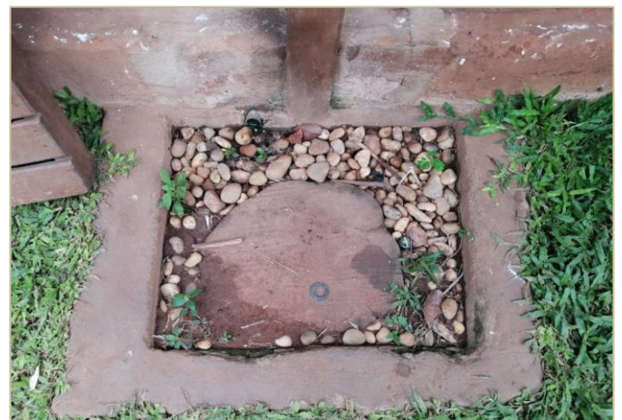
Puits d'infiltration en silo de gravier utilisé pour la collecte et l'infiltration des eaux usées domestiques à Womey, Novembre 2020
