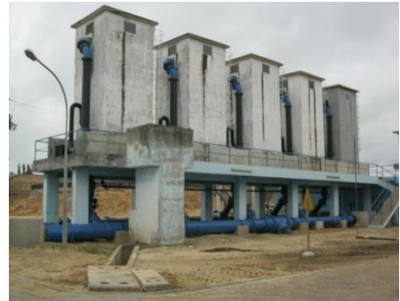
Photo 7 : installation de dégazage dans l'usine de Vêdoko
