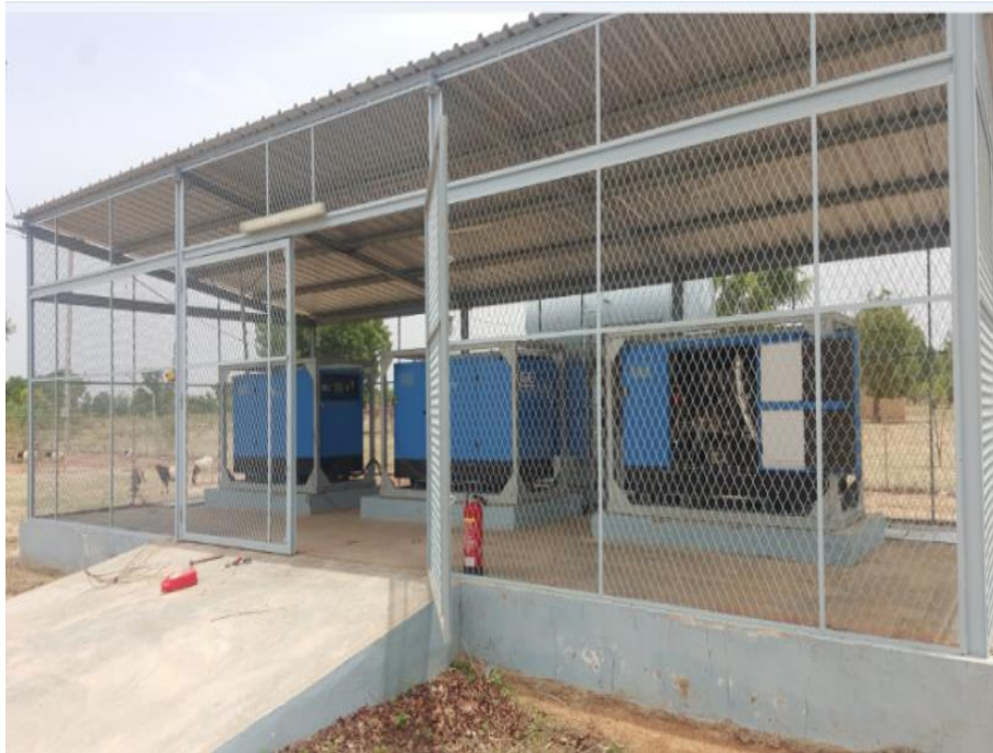
Figure 12 : Les trois groupes électrogènes (70 kVA)
