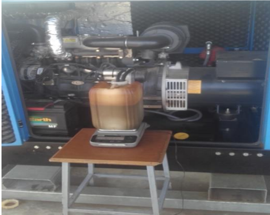
Figure 17 : Groupe électrogène en situation de test
