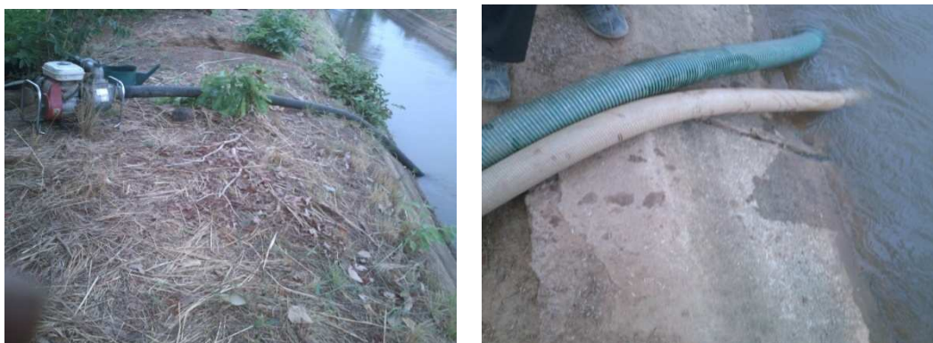
Figure 22 : Motopompe et siphons actionnés sur le canal d'amenée
