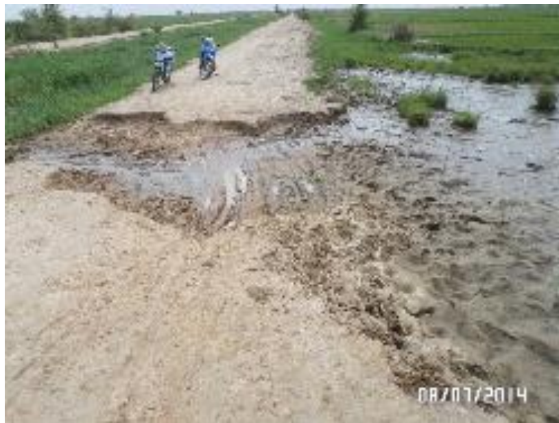
Figure 12: Route au niveau des drains KL0 et Sébougou; Source : KOUAKOU et KOUAMRE, visite de terrain, Juillet 2014
