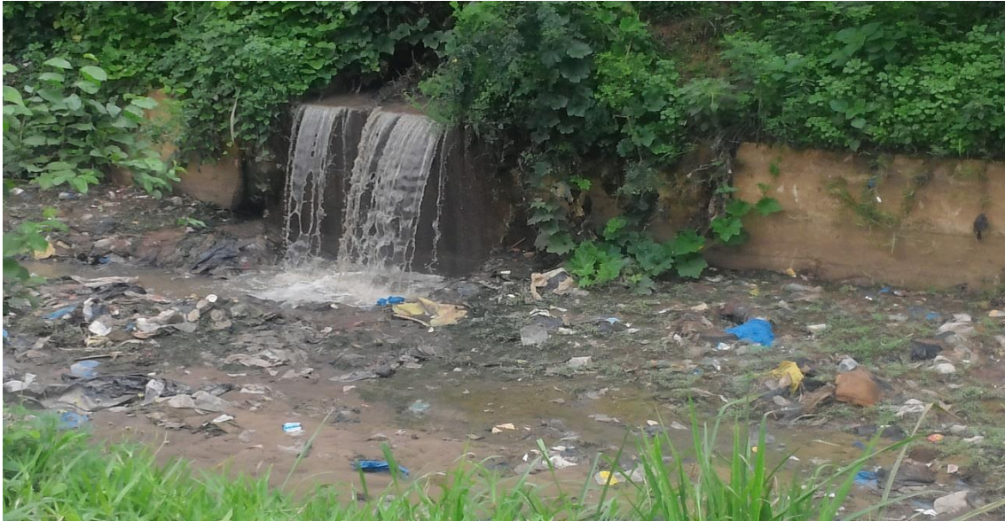
Figure 11: Dégueulement d'un regard du collecteur de base dans le canal d'évacuation d'eau pluviale
