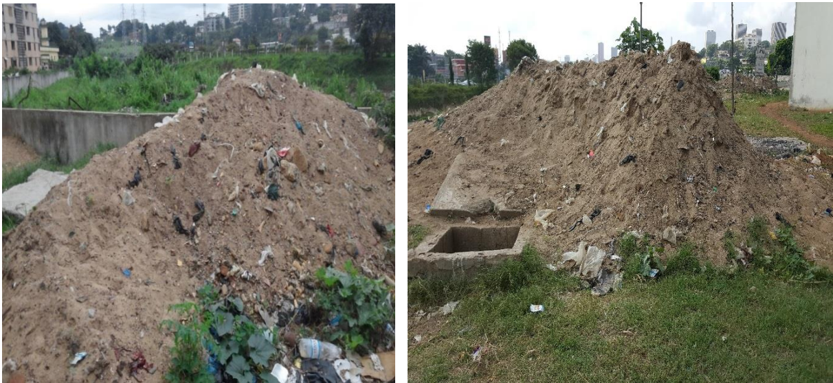
Figure 13 : Tas de sable issu d'un regard après un curage
