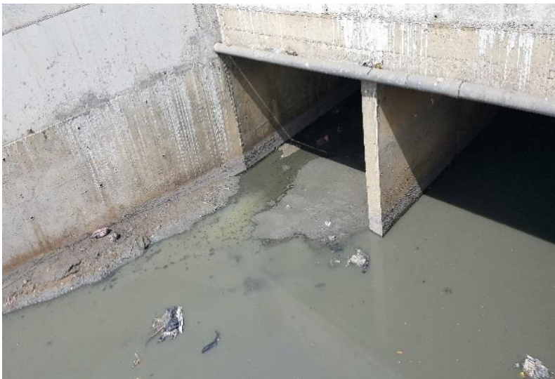
Figure 12 : Ecoulement d'eau usée dans le canal d'évacuation d'eau pluviale
