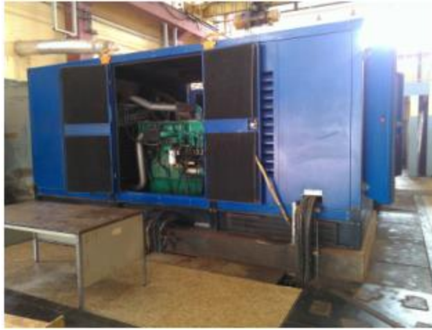
Photo groupe électrogène CUMMINS 300 kVA
