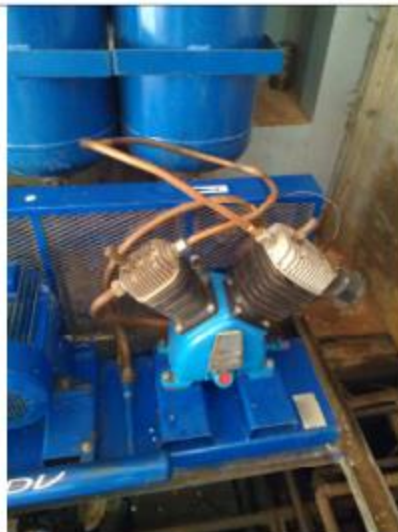
Tuyaux d'air non conformes - compresseur N° 2
