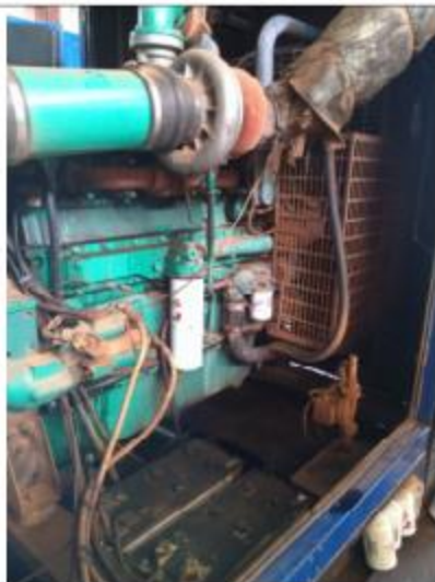
Protection calorifuge défectueuse sur tuyauterie échappement - GE 1
