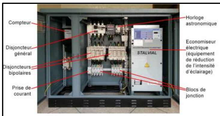
Figure 9 : Coffret de commande et de protection CPP
