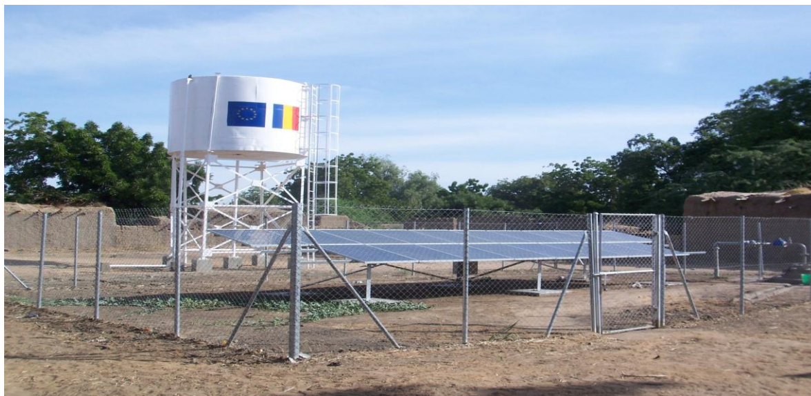
Photo 3: Station d'AEP alimentée par énergie solaire
