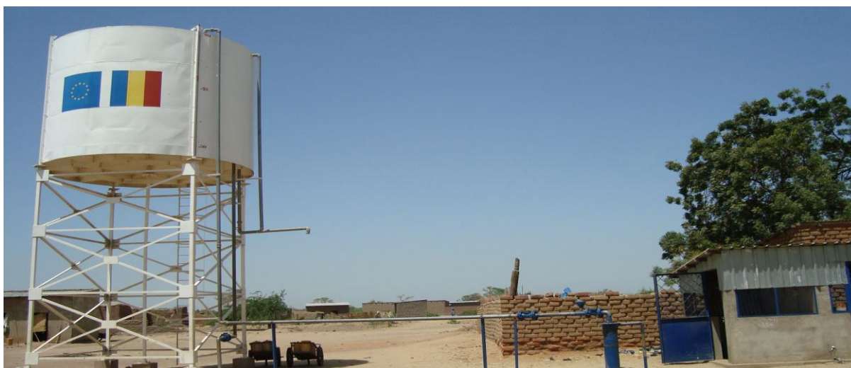
Photo 2: Station d'AEP de BESSADA alimentée par énergie thermique
