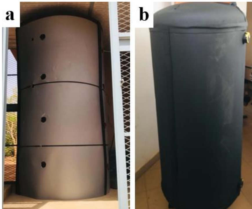
Figure 6 : (a) Réservoir d'eau chaude ; (b) Réservoir d'eau glacée.
