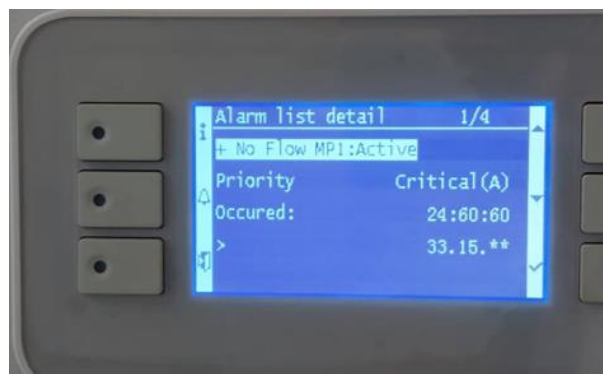
Figure 23 : Alarme d'erreur dans la machine à adsorption
