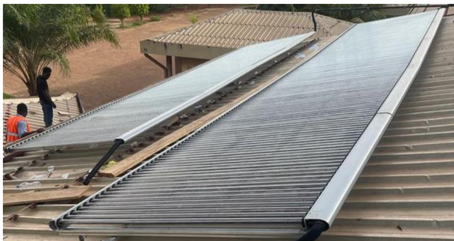
Figure 4 : Champ de capteurs solaires sous-vide.
