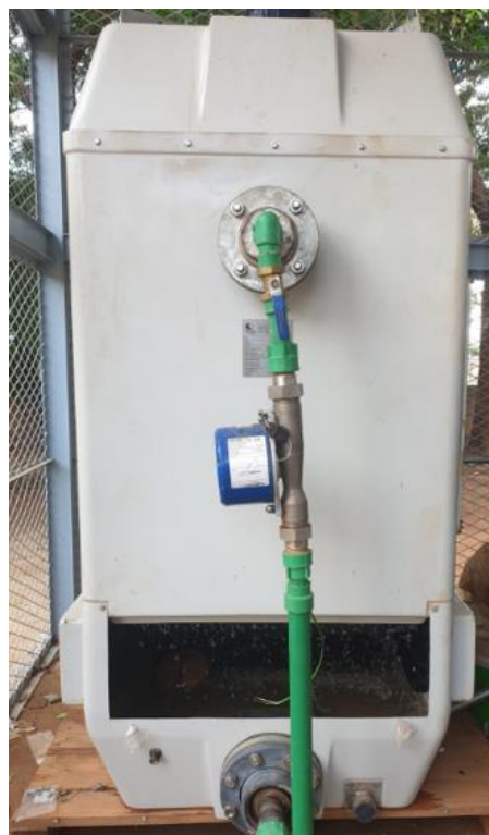
Figure 5 : Tour de refroidissement
