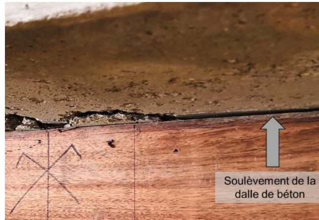
Figure IV- 35 : photo du soulèvement de la dalle de béton
