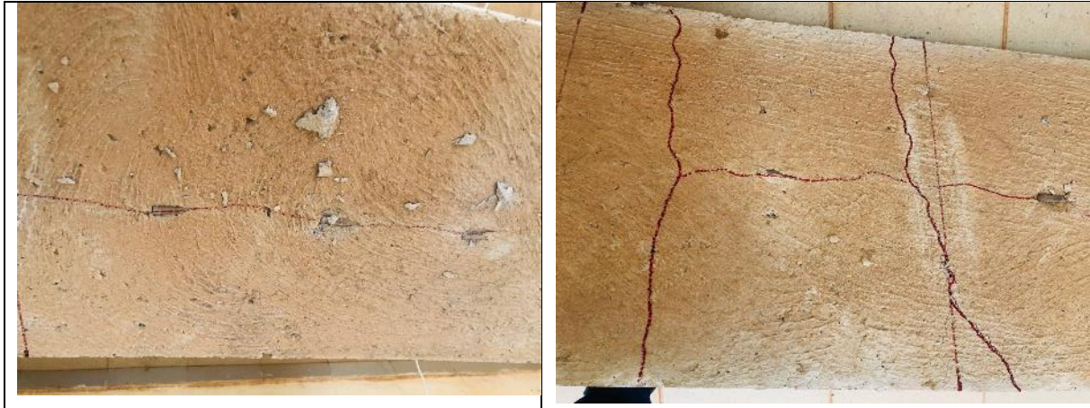
Figure IV- 21 : fissures longitudinales et transversales sur la face supérieure du béton
