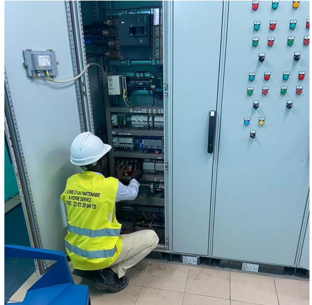
Annexe 12: Vérification du câblage des entrées sorties automate
