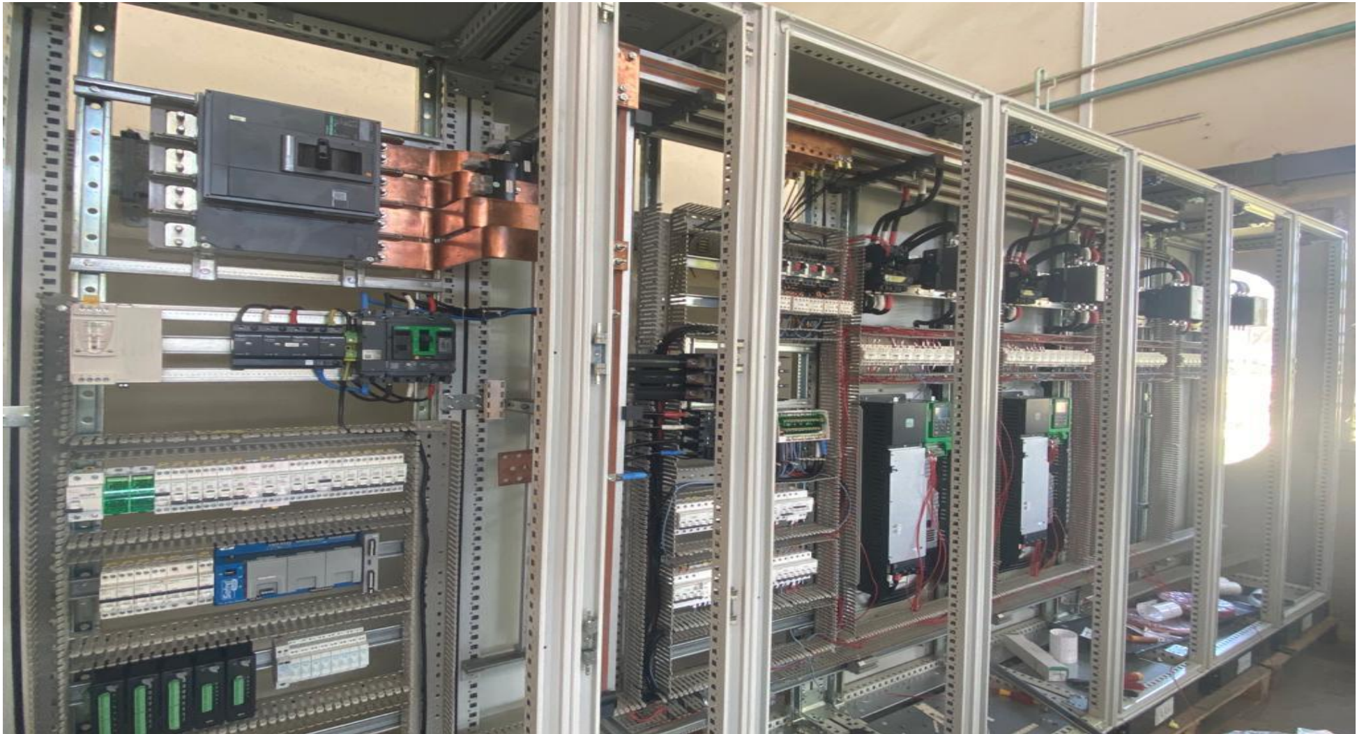
Annexe 11: Câblage de l'armoire en atelier chez Afric Power
