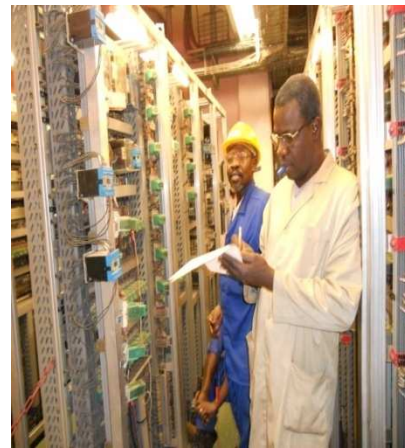
Photo 5: une vue d'une salle de relayage
