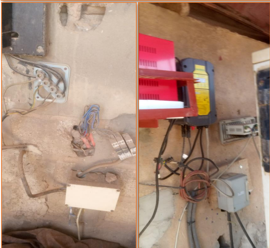
Mauvais branchements dans l'installation
