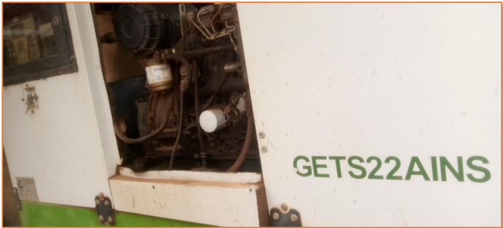
GE 20 kVA : Vieillissant mais encore actif
