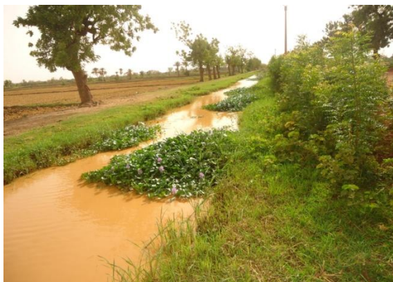
Photo 5 : partie en terre du CP n°1 envahi par les plantes
