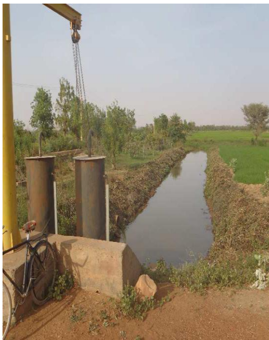
Photo 9 : Les deux pompes de la station de drainage
