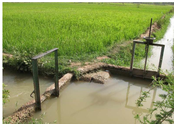
photo 8 : Vanne de régulation de la main d'eau endommagée
