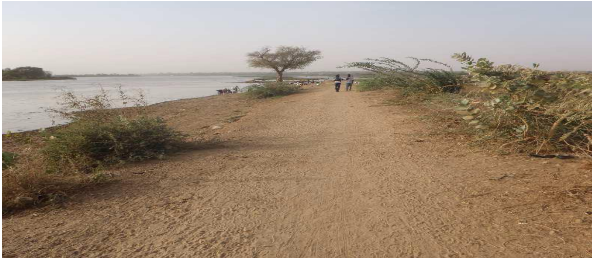
Photo 11 : Forte dégradation de la digue de protection
