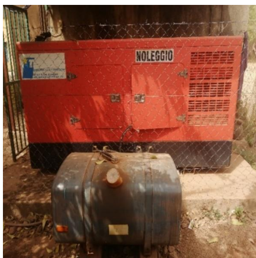
Figure 17. Groupe électrogène installé sur le site.
