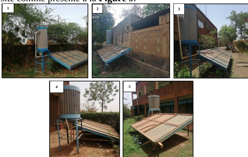
Figure 9. Les installations de solaire thermique du site.
