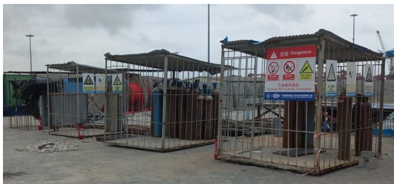
Figure 4 : Stockages des bouteilles de gaz
