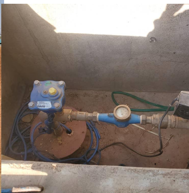
Image 5: équipement hydromécanique de la tête de forage en bon état
