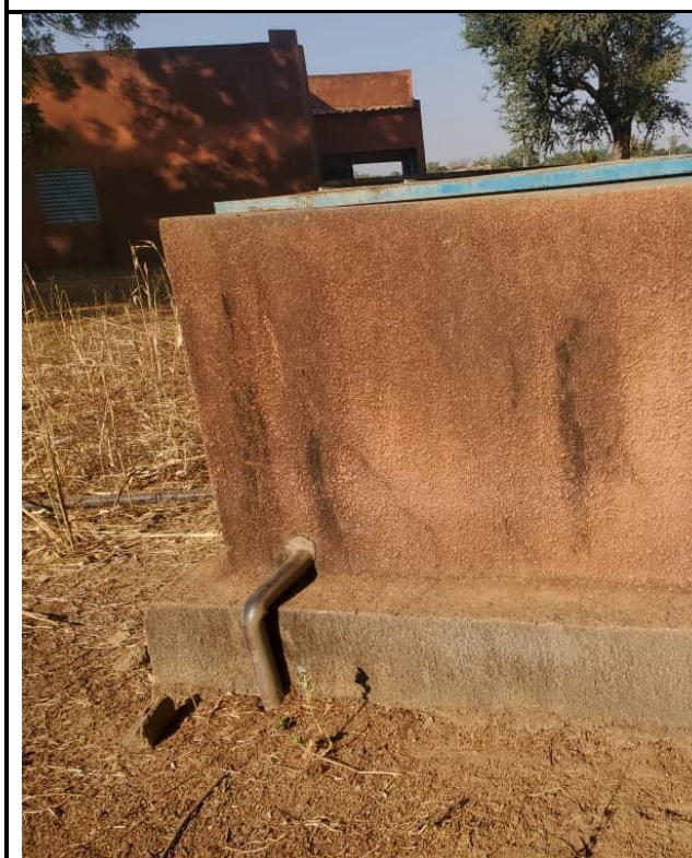
Image 4 : Regard tête de forage en bon état
