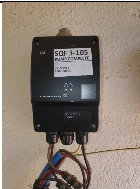
Image 9: Onduleur de la pompe type GRUNDFOS CIU 903
