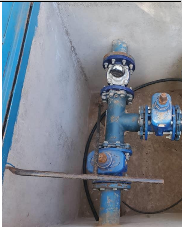
Image 7: By pass enterré en bon état
