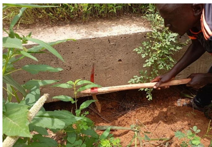
Annexe 15 : Ensablement du dalot au Pk 27+215
