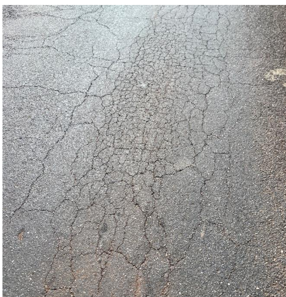
Annexe 6 : Faïençage de gravité 2 au PK 21+855
