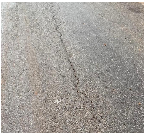
Annexe 5 : Fissure longitudinale de gravité 1 au PK 27+343
