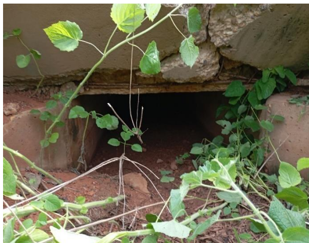
Annexe 16 : Fissure de la tête du dalot au PK 21+384
