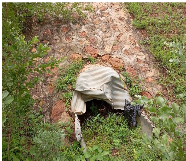
Annexe 17 : Buse obstruée au PK 29+625
