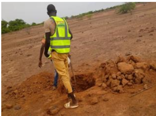
Annexe 19 : Recherche de gîte de matériaux au PK 29+000
