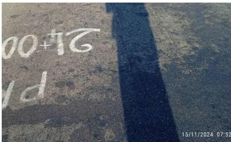
Annexe 4 : Ressuage de gravité 2 au PK 24+000
