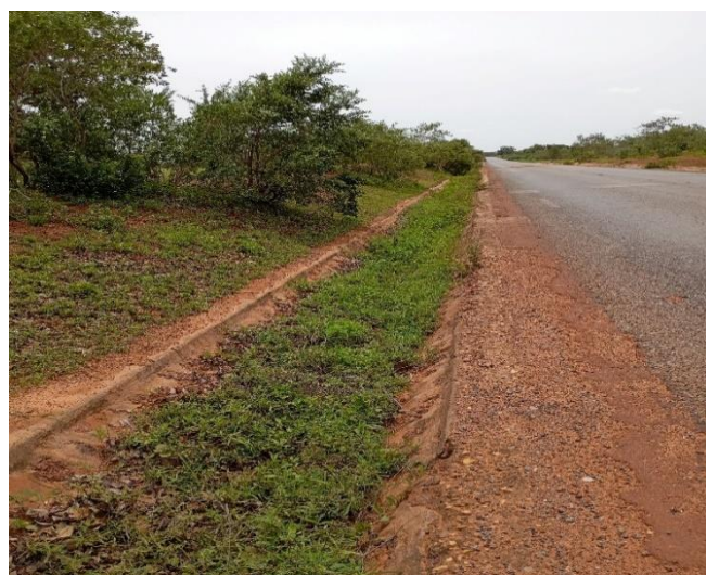
Annexe 18 : Présence d'herbe dans le fossé au PK 24+640
