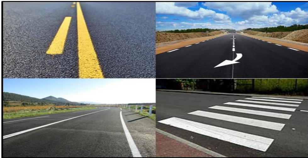
Figure 11 : quelques signalisations horizontales
