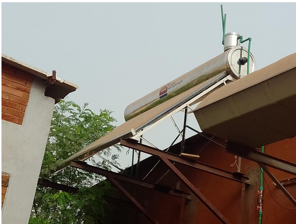
Figure 31. Buanderie d'hôpital : installation du CES à tubes sous-vide à côté du CES autostockeur.
