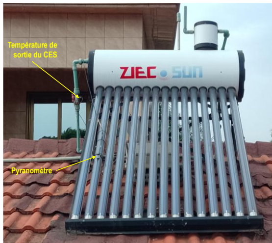
Figure 20. CES installé sur le toit du ménage à Lomé.
