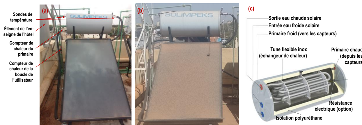
Figure 19. (a) CES suivi dans l'hôtel à Ouagadougou (nettoyé), (b) recouvert de poussière, et (c) vue éclatée du réservoir.
