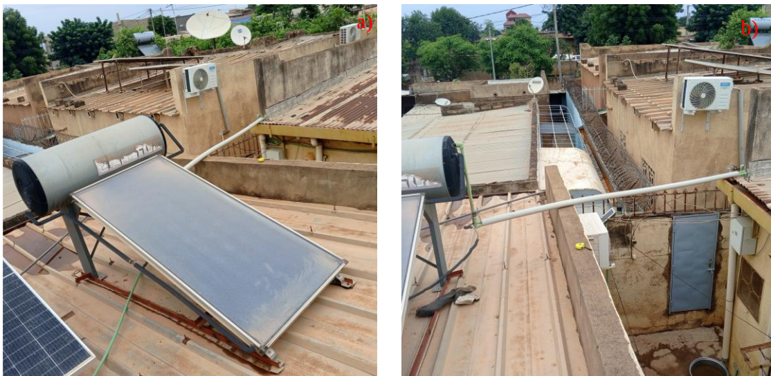
Figure 21. CES installé sur le toit du ménage à Ouagadougou.
