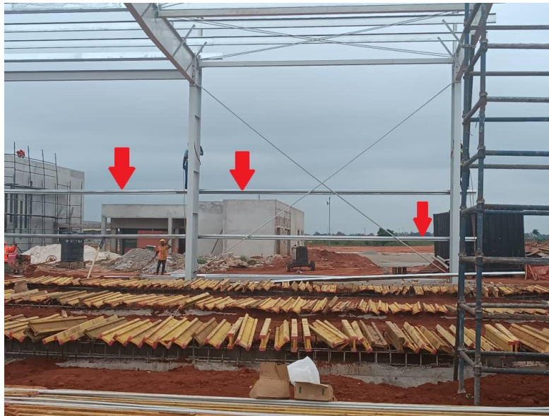
Figure 10 : Aperçu des lisses de bardage
