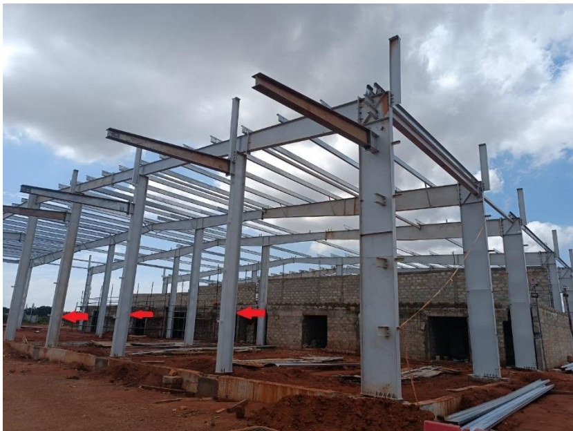
Figure 12 : Aperçu des potelets
