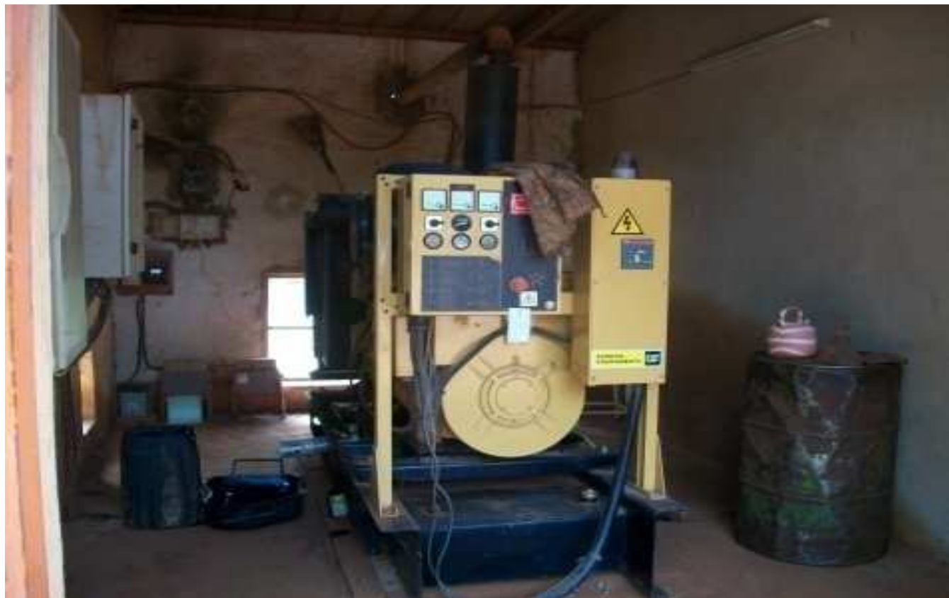
Photo 15 : Local abritant le groupe électrogène
