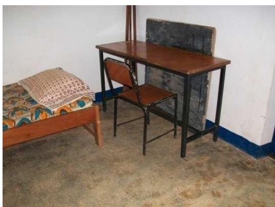
Photo 19 : Plancher et mur d'une chambre
