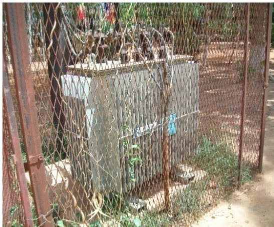
Photo 13 : Transformateur de 400 kVA de la zone K1 du site
