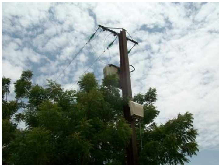
Photo 14 : Transformateur de 100 kVA de la zone K3
