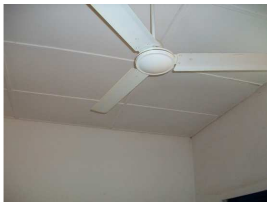
Photo 18 : Faux plafond et mur d'une
