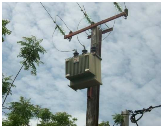
Photo 12 : Transformateur de 100 kVA de la zone K2
