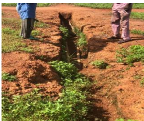
Tranché de conduite de distribution dégradée
