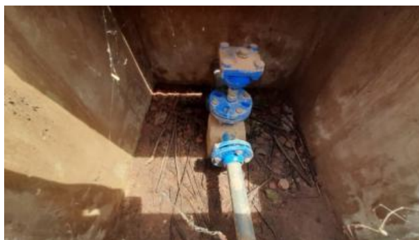
Ventouse en mauvais état
